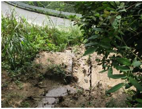
排水溝が詰まり土砂があふれた
