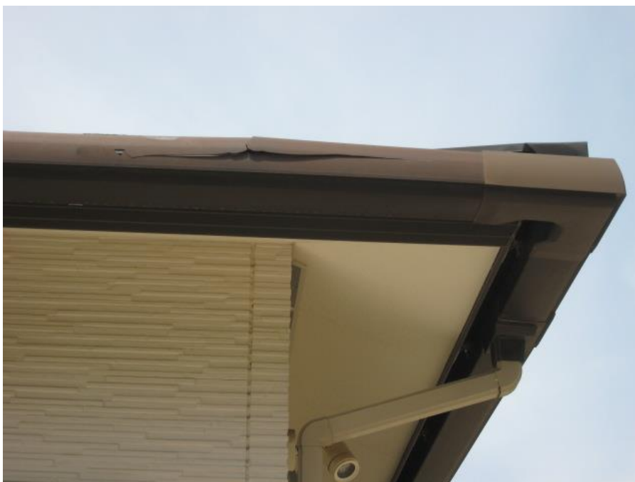
破損した軒樋
