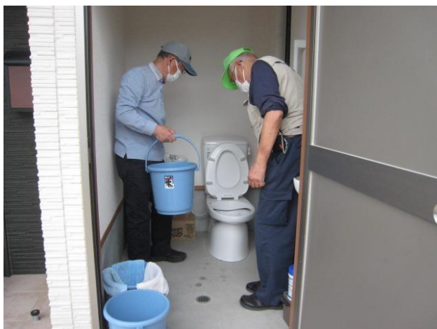
水タンクに常時 500ℓの水を貯水 災害時にこの水を便器内の汚物処理水として使用します。
