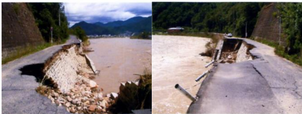
太田川沿いの可部宇津線は、旧亀山発電所付近が冠水し護岸も崩れ一時通行止めでした
